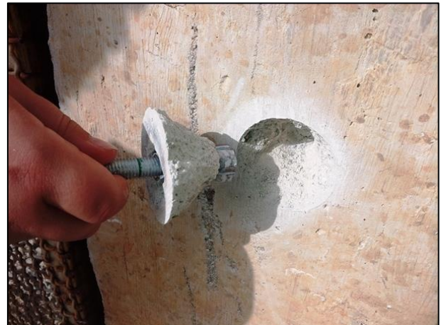
Figura 4.38: Situazione finale in seguito ad indagine pull-out
